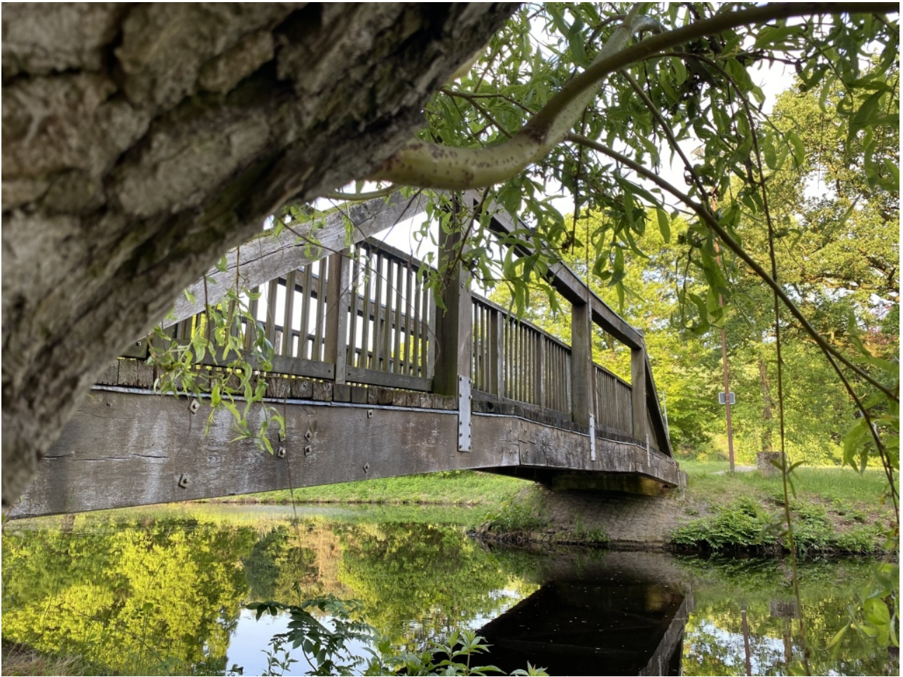
Die marode Brücke am Bocholter Rodelberg wird bald ersetzt. © Stadt Bocholt
