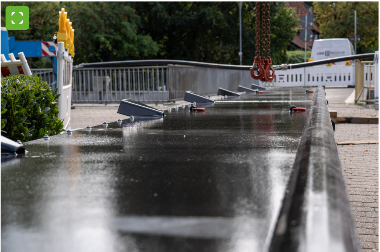
Das Stauwehr an der Königsmühle hat eine neue Klappe
