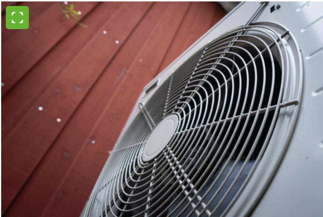
Teil einer Luftwärmepumpe
